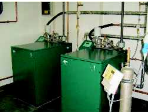
Heizzentrale mit Blockheizkraftwerk
