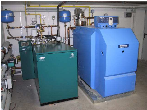
Abb. 2: Heizzentrale für das 4- und 7l-Haus
