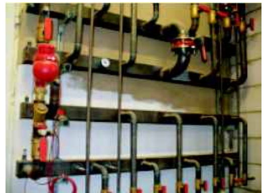
Heizverteilung für Wärmenutzung
