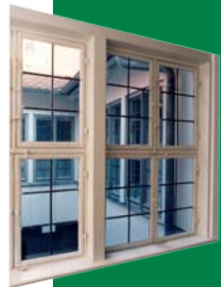
Der denkmalpflegerische Mehraufwand hat sich gelohnt. Ein originales, 300 Jahre altes bleiverglastes Holzfenster mit Durchblick in den Innenhof und umgebende Altane
