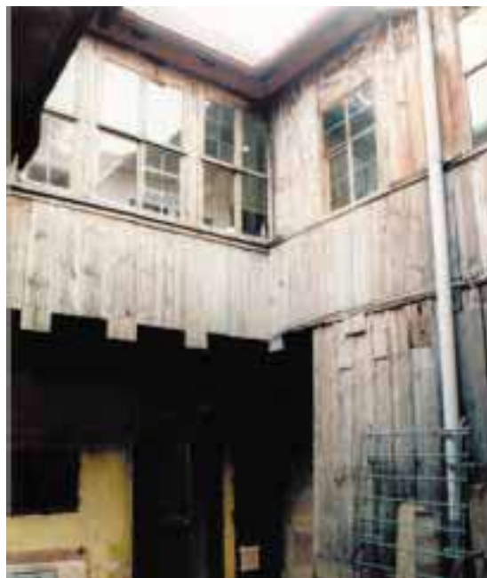
Ein herunter gekommener Innenhof in der Theaterstraße. Fachleute erkennen auch in diesem Zustand das Potenzial des Gebäudes
