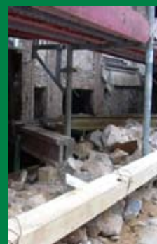
Umfangreiche Sanierungsarbeiten an der Altbausubstanz: Abscherender Holzstützenfuß (oben), Unterfangungen am Laubengang (Mitte) und am Sockel (unten)
