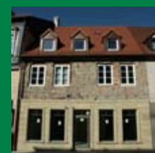
Schrittweiser Schaufensterrückbau und Neugliederung der Fassade mit Vollwärmeschutz des Obergeschosses – die Entwürfe nehmen Gestalt an
