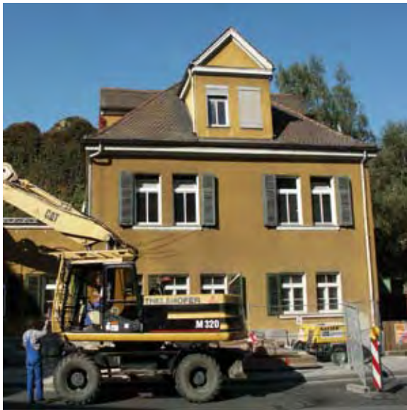
Kulturzentrum E-Werk – Beginn der Sanierung des ehemaligen Wohnhauses zur künftigen Nutzung als Verwaltungstrakt Foto: Stadt Erlangen
